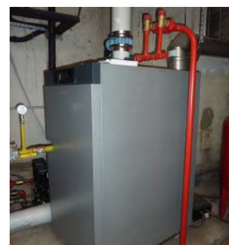
Chaudière gaz à condensation
