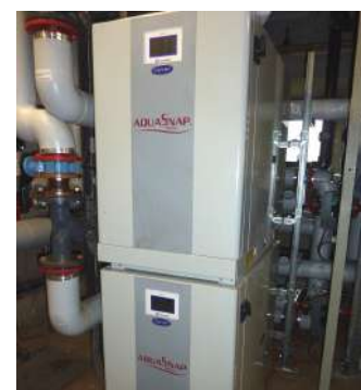
Pompes à chaleur
