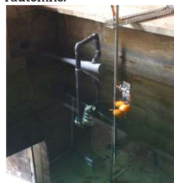
Pompe de relevage
